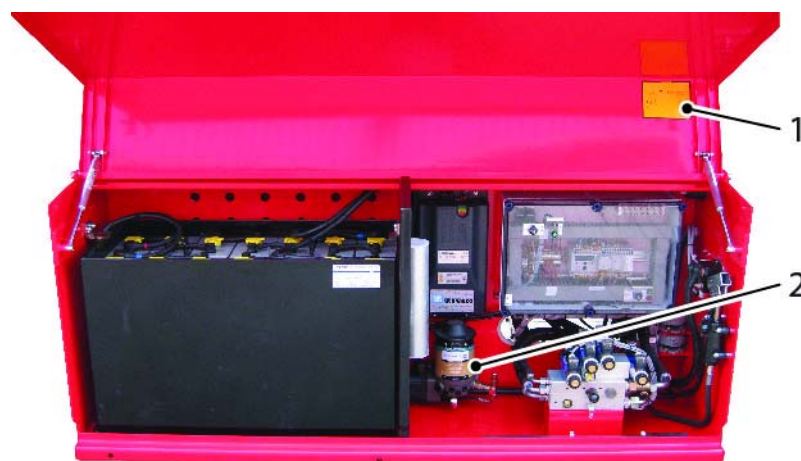
Ventielen/elektracompartiment en centraal vetsmeersysteem
